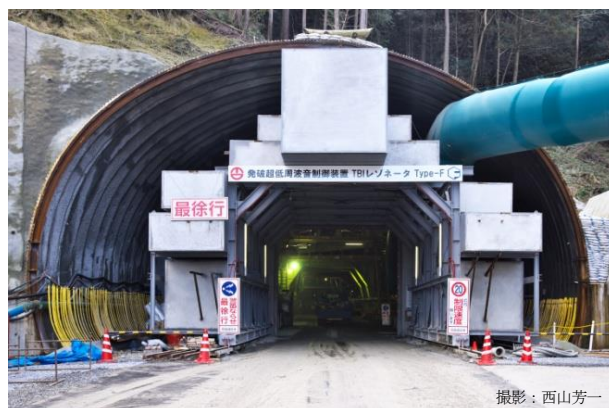
消音装置設置状況
