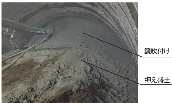
写真-1 崩落状況 (押え盛土, 吹付コンクリート)
