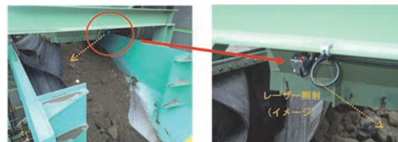
写真-3 グリズリフィーダ制御（レーザーセンサ設置）
