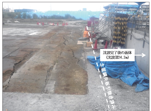
写真-2 ケーソン工事による地盤変状の事例
