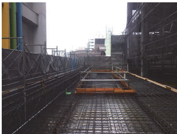
写真-13 スラブ開口状況
