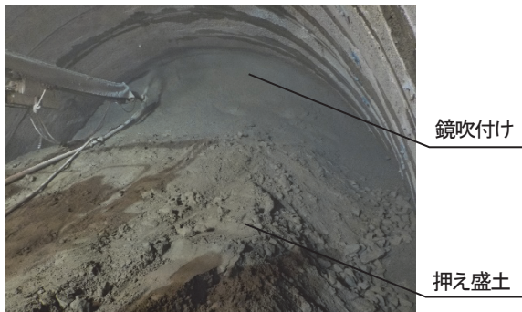
写真-1 切羽崩落状況
