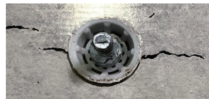
写真-1 Pコーン部のひび割れ
