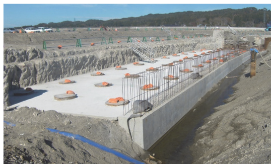
写真-1 直立堤応力遮断壁の露出状況
