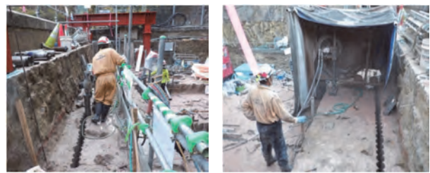
コアボーリングによる切断 ワイヤソーによる切断 写真-4 既設構造物の撤去状況
