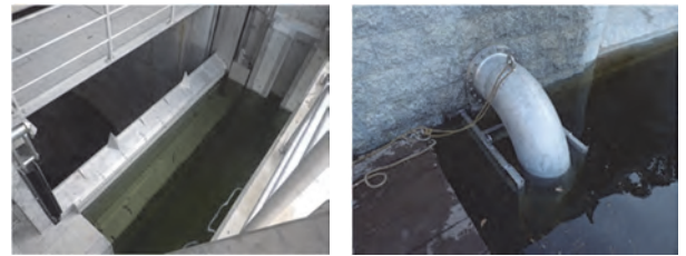
二段式ゲート(表層放流設備) 放流管(底層放流設備) 写真-6 放流設備
