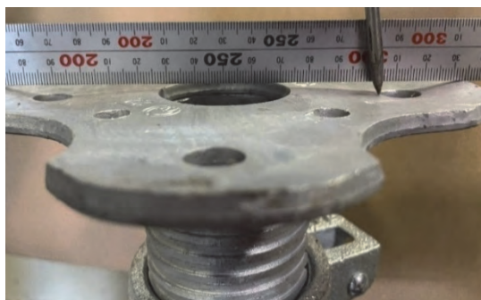
写真-1 パイプサポートの隙間
